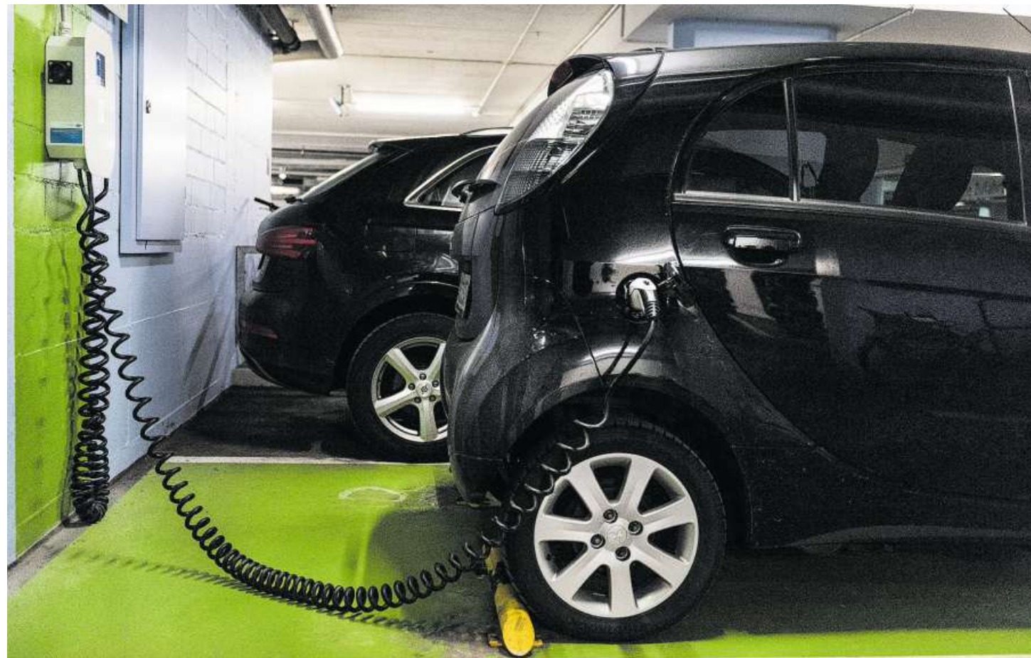
Auch in Parkhäusern in St. Gallen gibt es Ladestationen für Elektroautos. Die St.Galler Stadtwerke betreiben alleine 59 öffentliche Ladepunkte auf dem Stadtgebiet – und es sollen bald mehr werden.
