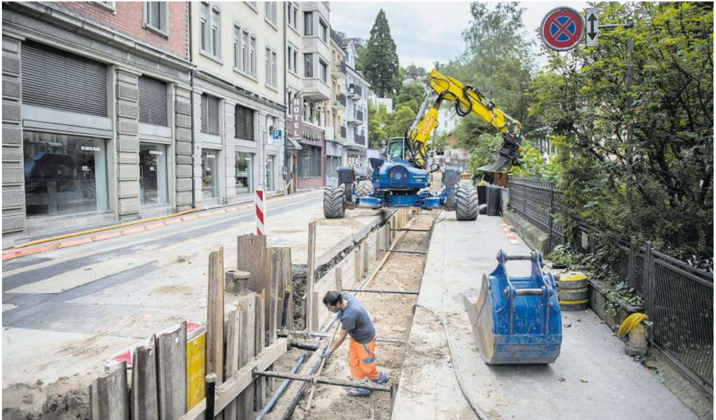
Das städtische Fernwärmenetz ist seit 2010 ausgebaut worden (im Bild der Untere Graben). Jetzt soll die zweite Etappe folgen. Bild: Urs Bucher
